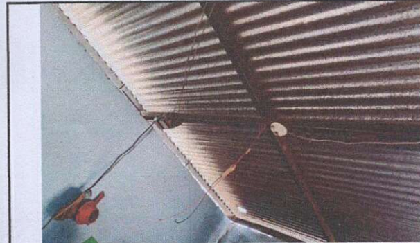
Foto 4: El sistema eléctrico de toda la escuela se encuentra en mal estado, desde el tablero de flípones de distribución.
